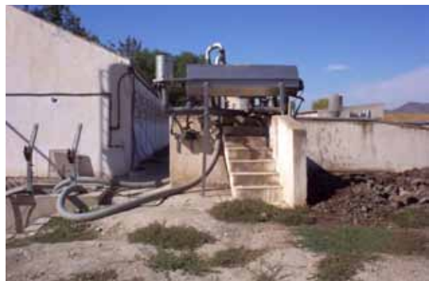
Aspecto general de un separador de fases en una granja porcina.
