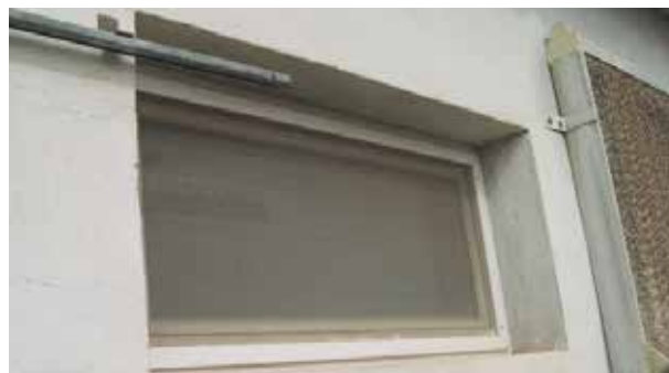
Figura 2: La colocación de telas mosquiteras en las ventanas previene la entrada masiva de moscas al interior de la granja.
